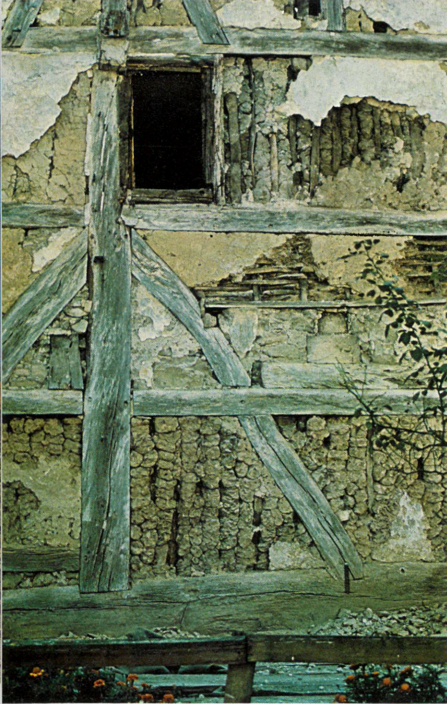
Pignon de la maison de Schlierbach (XV e siècle) avant démontage ; vue de détail montrant divers types de torchis : en boules (d'origine), sur clayonnage (plus tardif), ainsi que les assemblages.
