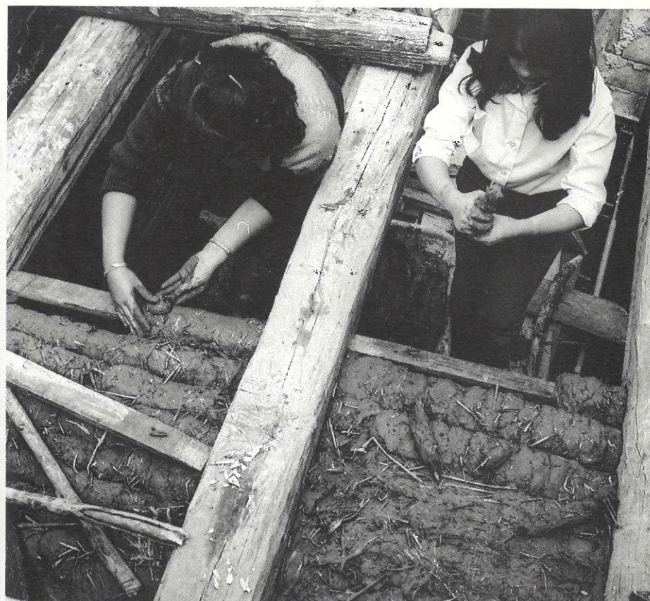
Reconstitution par des écoliers du plafond original en torchis, dans le pavillon de Ribeauvillé.
