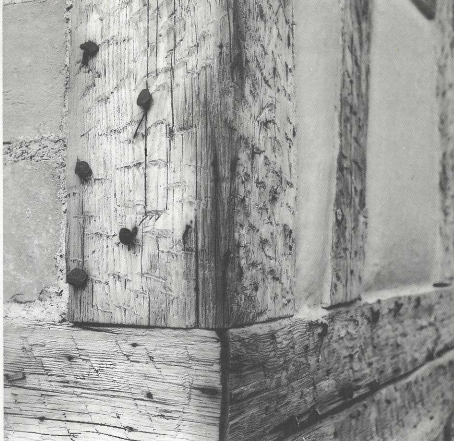
Angle du colombage du pavillon de Ribeauvillé mettant en évidence les artifices utilisés pour favoriser l'accrochage de l'enduit sur le bois.
