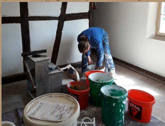
En 2017, le bâtiment avait déjà bénéficié du renouvellement de la toiture et d'une réfection intérieure, les enduits et les peintures en particulier, mais sa structure est très abîmée.
