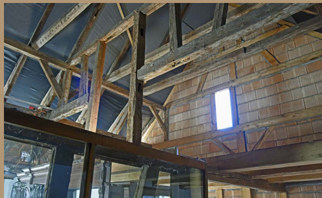
Le mur extérieur est refait, le plancher démonté, le bâtiment va changer d'aspect pour accueillir la pharmacie.
